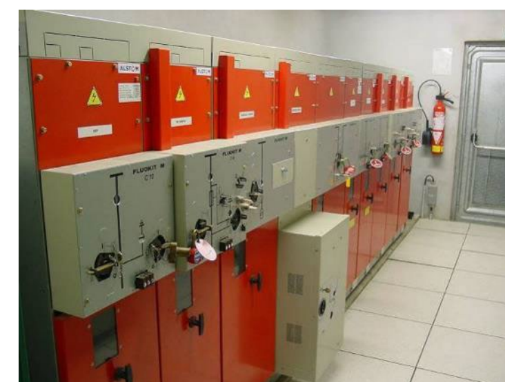
Illustration 11 : Intérieur d'un poste de livraison
